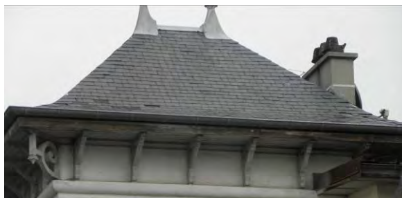
Coyau qui assouplit la pente du toit . Arêtier à joint vif sans zinc de recouvrement.
