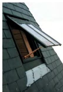
fenêtre de toit en acier (photo cast-pmr)
