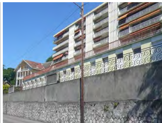
Interdit : la surélévation des murs existants
