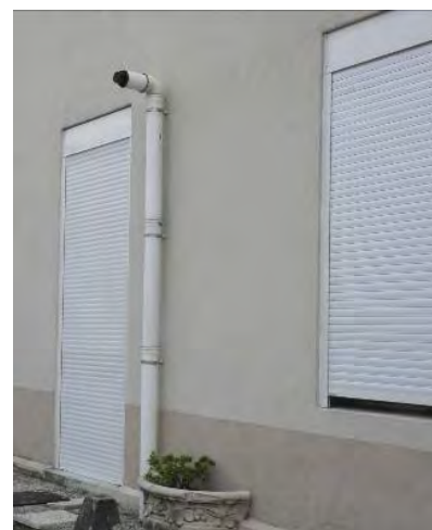
Interdit : volet roulant au nu de la façade extérieure et de teinte blanche, caisson apparent.
