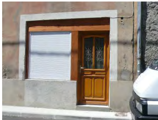
Interdit : bouchement en maçonnerie ou agrandissement d'une ancienne ouverture
