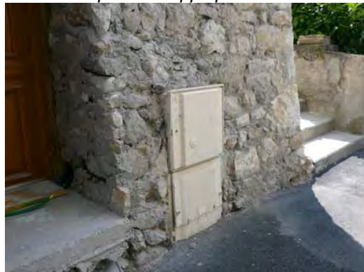
Les coffrets devraient être en retrait et cachés derrière une porte
