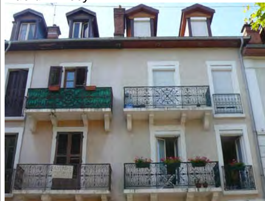
Rue du commerce Changement partiel des menuiseries sans cohérence ni préoccupation de l'ensemble de la façade
