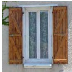
interdit: Menuiserie plastique et montants épais: ici la surface pleine (cadre + ouvrant) est presque aussi importante que celle du vitrage Le vitrage plein jour banalise la façade.
