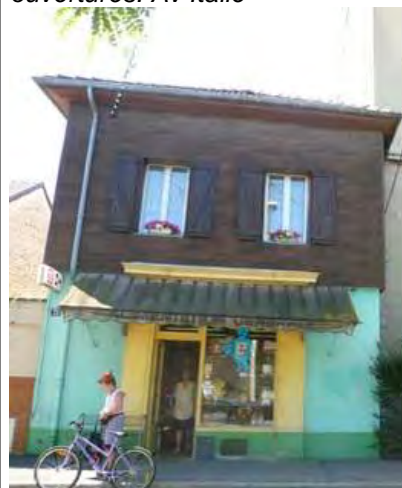
Façade d'origine dénaturée : partition horizontale, traitements différenciés, teintes criardes, bannière trop large.
