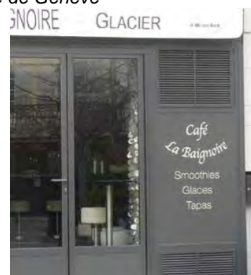
Les climatiseurs peuvent être placés derrière des panneaux ajourés.
