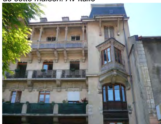
Les menuiseries et occultations différentes nuisent à la cohérence d'ensemble.
