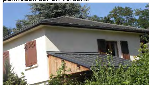
Exemple d'intégration de panneaux solaires en auvent
