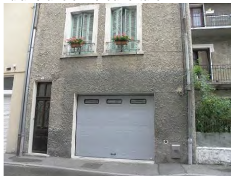
Le percement ne respecte pas la trame des ouvertures existantes, les matériaux et leur finition ne sont pas adaptés.
