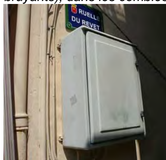
Interdit : la pose en applique
