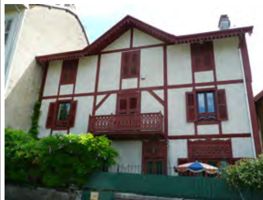
Pans de bois avenue Berthollet. Une isolation par l'extérieur ferait perdre tout son caractère à cette façade.
