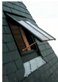
fenêtre de toit en acier (photo cast-pmr)
