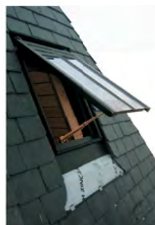
fenêtre de toit en acier (photo cast-pmr)
