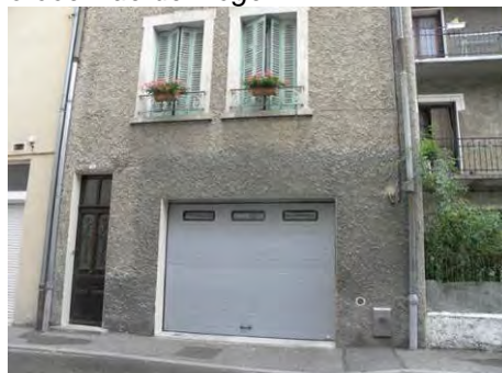
Le percement ne respecte pas la trame des ouvertures existantes, les matériaux et leur finition ne sont pas adaptés.
