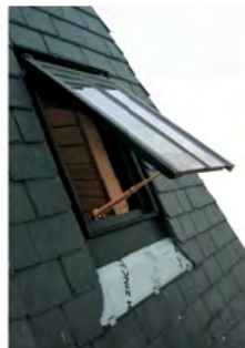
fenêtre de toit en acier (photo cast-pmr)
