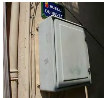
Interdit : la pose en applique
