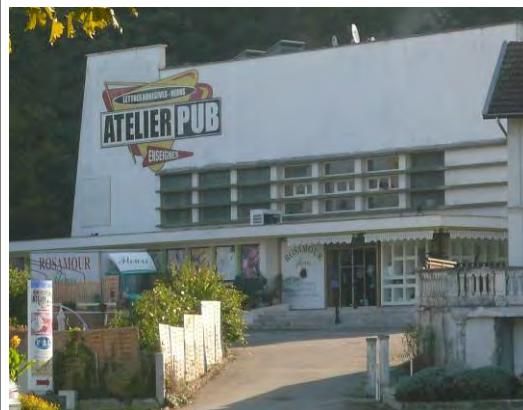
Les différentes interventions (traitement morcelée du rez-de-chaussée, climatiseurs, enseignes) dénaturent la façade de ce bâtiment intéressant à l'origine (ancienne usine de yaourts). Av Charcot
