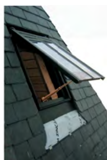
fenêtre de toit en acier (photo cast-pmr)
