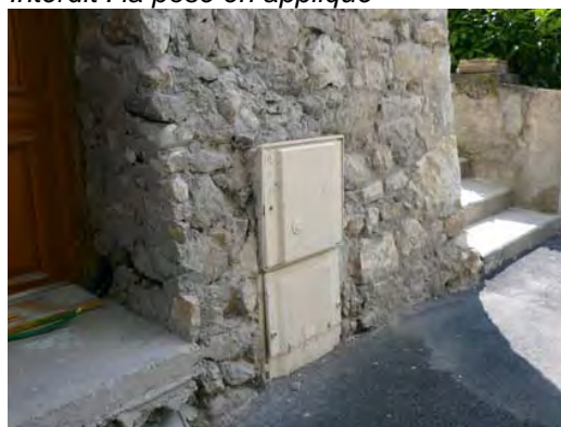
Les coffrets devraient être en retrait et cachés derrière une porte
