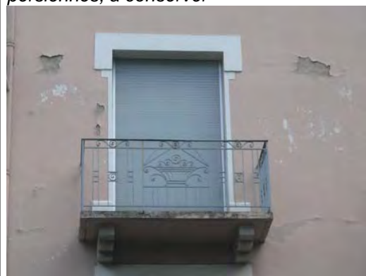
Av du Grand Port, volet roulant bien intégré (teinte, position, coffret invisible)
