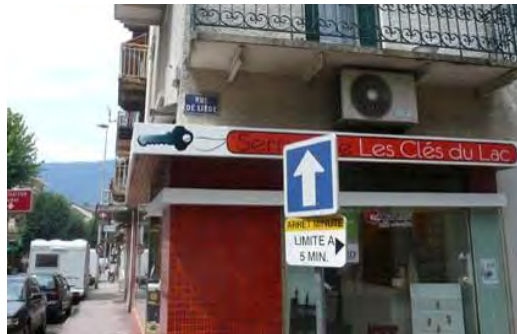
Interdit : Habillage rapporté, climatiseur en applique. Rue de Liège
