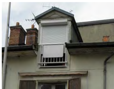
A proscrire : disproportion de la lucarne, pose de volets roulants avec caisson extérieur, matériau inadapté
