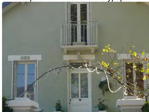
Banalisation d'une façade par la pose de menuiseries de fenêtre standard
