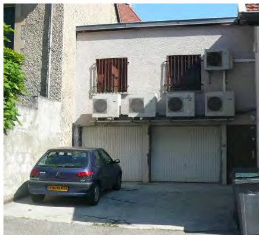
Les climatiseurs les coffrets techniques ne doivent pas être visibles depuis la rue.
