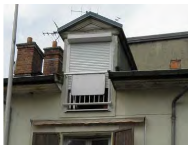
A proscrire : disproportion de la lucarne, pose de volets roulants avec caisson extérieur, matériau inadapté
