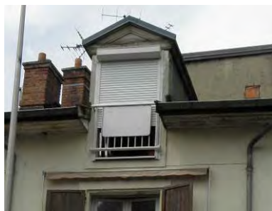
A proscrire : disproportion de la lucarne, pose de volets roulants avec caisson extérieur, matériau inadapté
