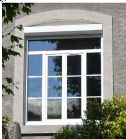
Interdit : partition pas adaptée , montants épais accentués par le blanc et caisson du volet roulant qui coupe le profil de l'ouverture
